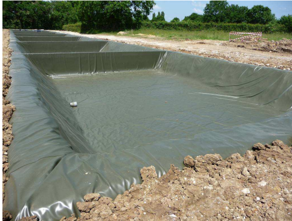
Bassin de rétention avec étanchéité par géomembrane
