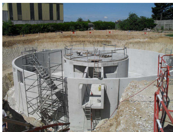
Bassin de rétention en béton armé
