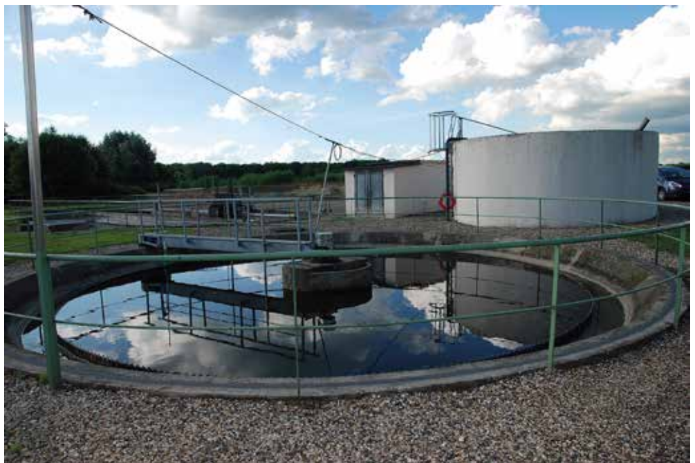
Station d'épuration : le clarificateur
